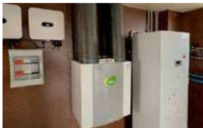
Sistema de Ventilación de la vivienda
