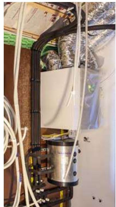
Sistema de Ventilación de la vivienda
